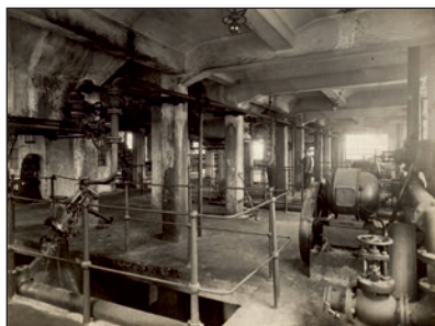
Wazelnia – górna część wazników obrotowych
